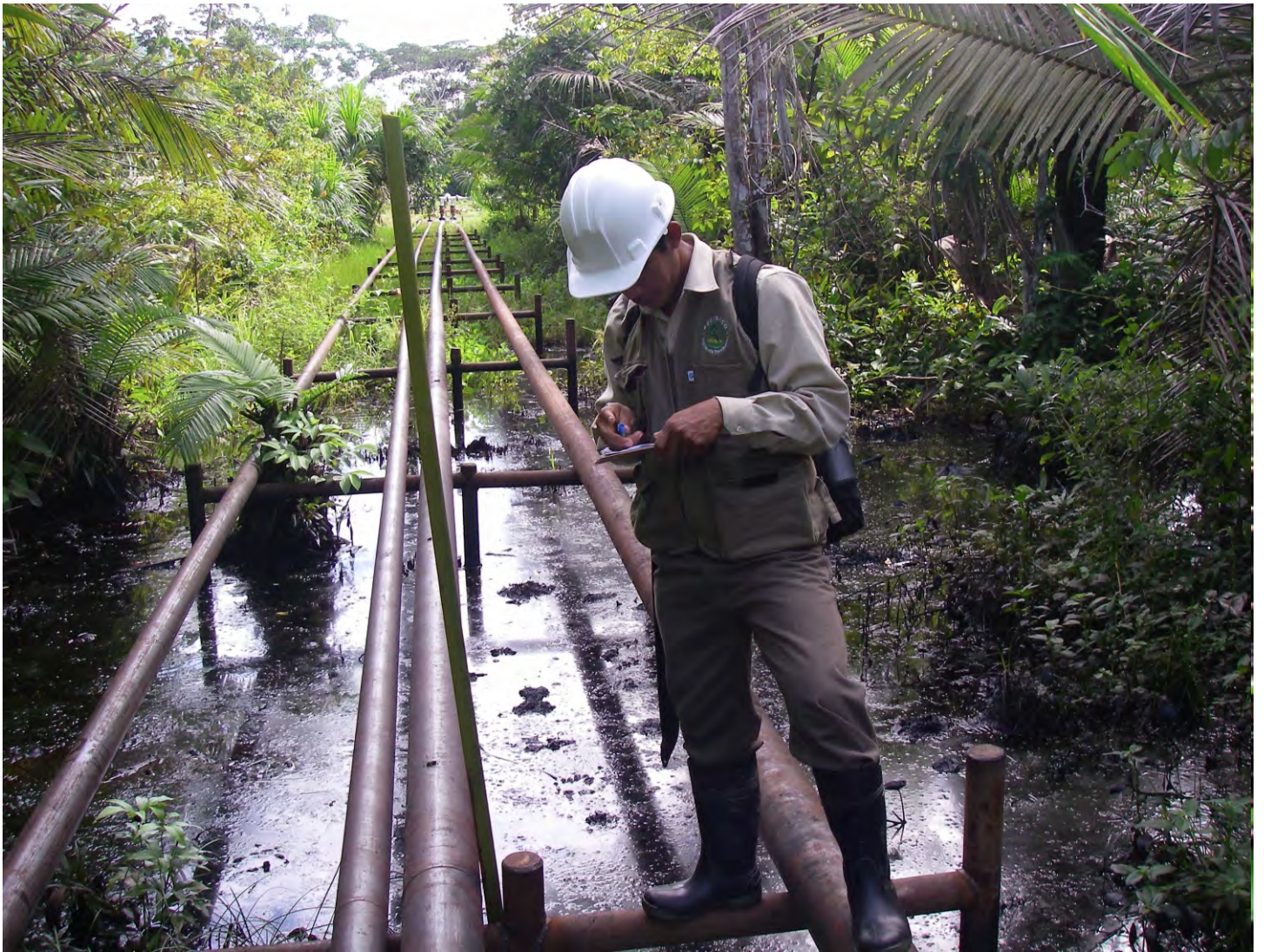
Monitor de Feconaco documentando un sitio contaminado abajo de tubería. Lote 8 (PA-BAT2-08-01). 20/06/08
